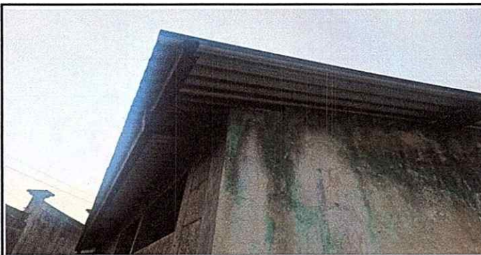
Foto 5: Problemas de humedad en el exterior de la cocina.
